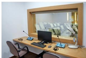
T102口譯控制室
